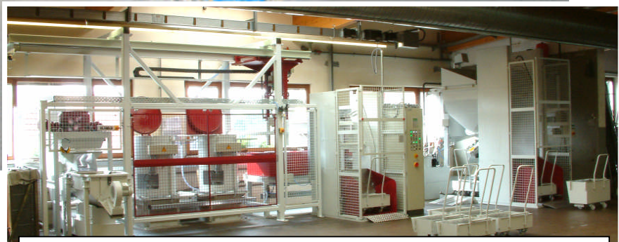
L'installation pour l'élimination des copeaux: TTS 600 avec broyeur de copeaux et nettoyage du réfrigérant lubrifiant
